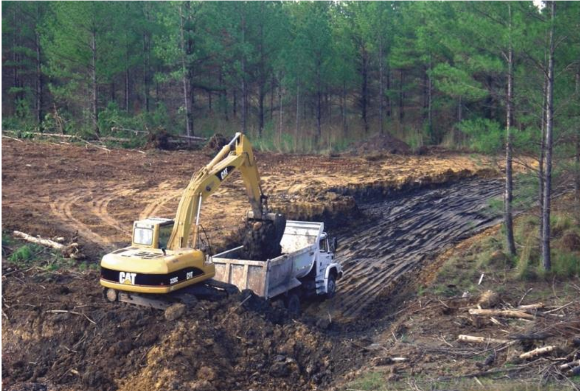
Figura 6: Escavadeira e caminhões de pequeno porte são utilizados para retirar o solo que recobre as camadas de carvão (CRM, 2017).
